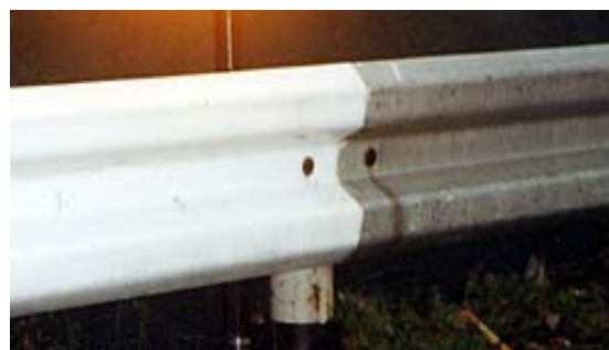
図 15 沿道ガードレールにおける空気浄化用光触媒塗料の防汚効果(左:光触媒塗装品、右:従来品。東京都板橋区大和町交差点)
